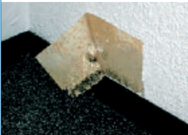
Bild 3: Schimmelpilzbefall unter der Tapete
